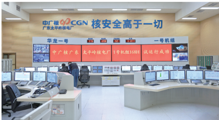
太平岭“华龙一号”一号机组试运行成功
